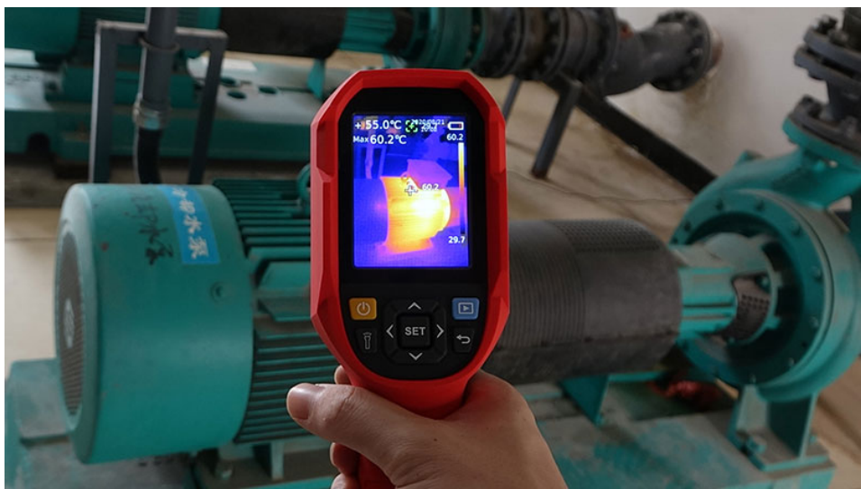
Kontrola pracy silników elektrycznych
