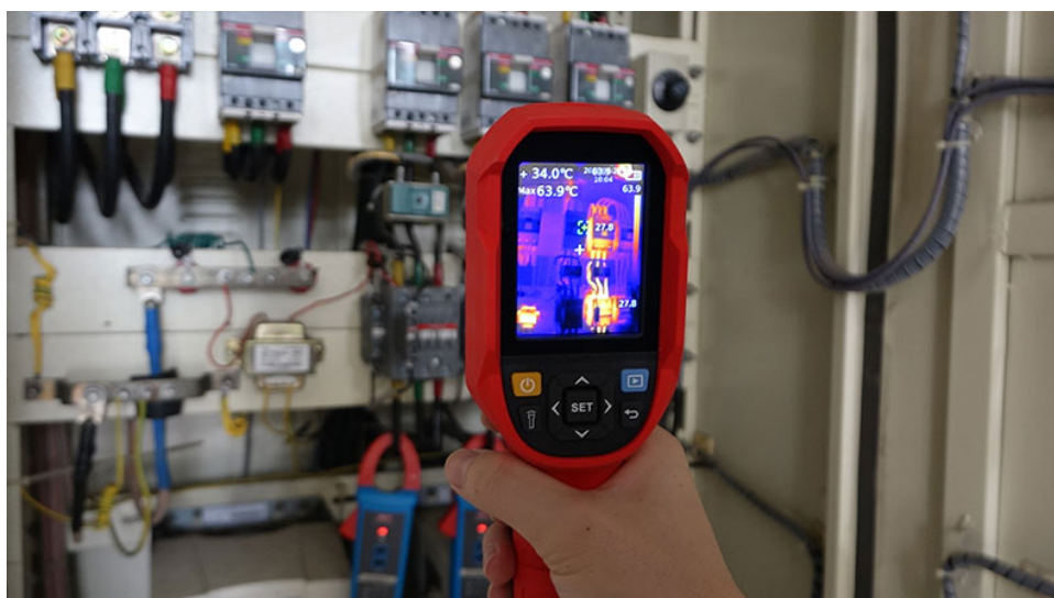
Kontrola w rozdzielnicach elektrycznych, szafach sterowniczych
