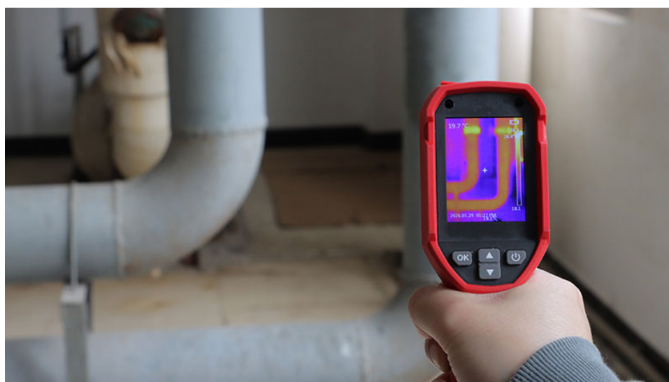
Ogrzewanie, ciepłownictwo, hydraulika - instalacje rurociągów
