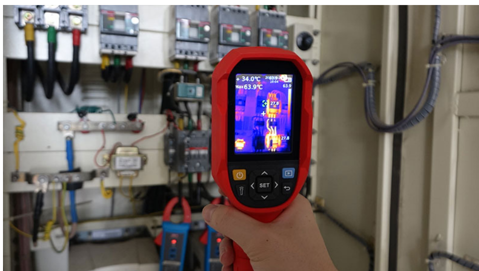
Kontrola w rozdzielnicach elektrycznych, szafach sterowniczych
