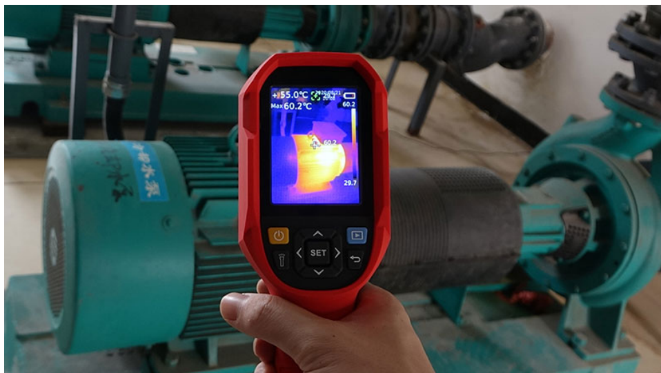
Kontrola pracy silników elektrycznych
